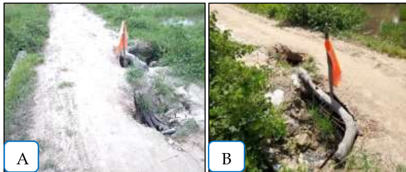
Photo iii: Délabrement des ponceaux sur la route départementale 14.2.00 au carrefour (A) et à Effoc (B) (Sources : Coly, septembre 2024)
